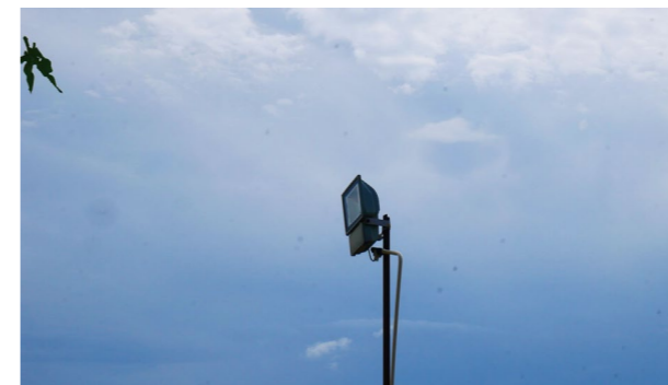
改善前：电源供电照明。
