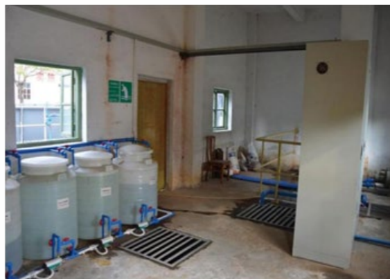
宏大民爆——污水处理设施
