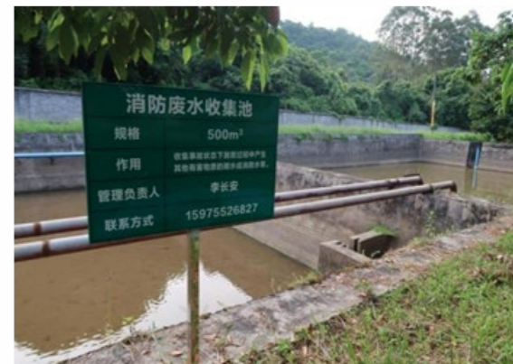
宏大民爆——消防废水收集池
